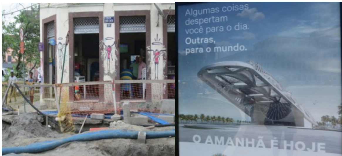
Figura 2 As obras na linha do VLT na rua Barão de Gamboa ( esquerda ) – direita Propaganda do Museu do Amanhã, (direita) foto Laura Burocco , 2016
